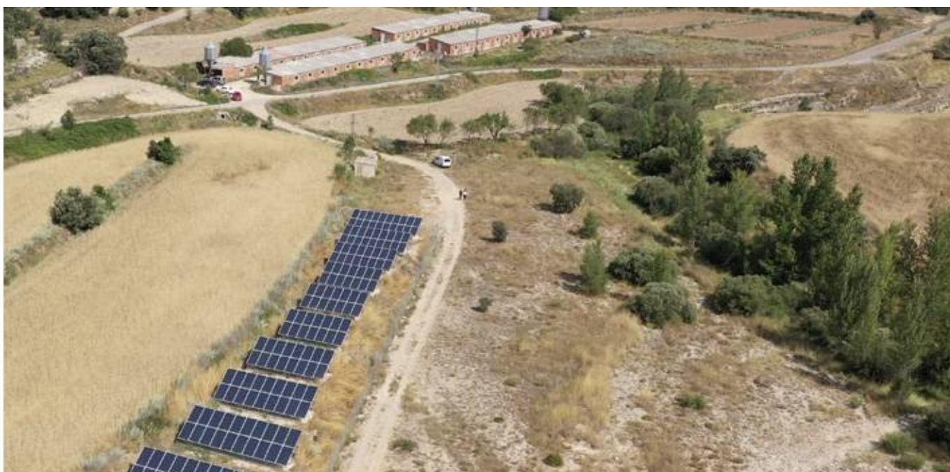
Bombeo solar aislado en La Cuba
