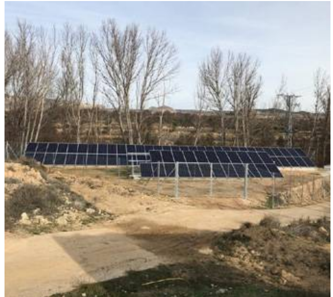
Bombeo solar en Alacón
