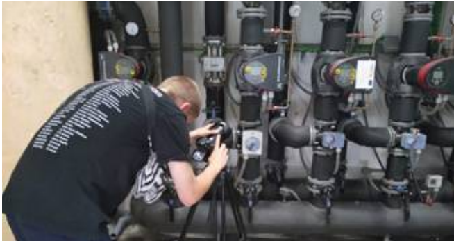
Sala calderas piscina climatizada Calanda
