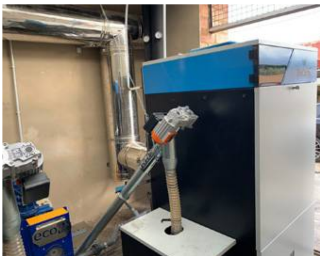
Caldera de biomasa de condensación en Hotel
