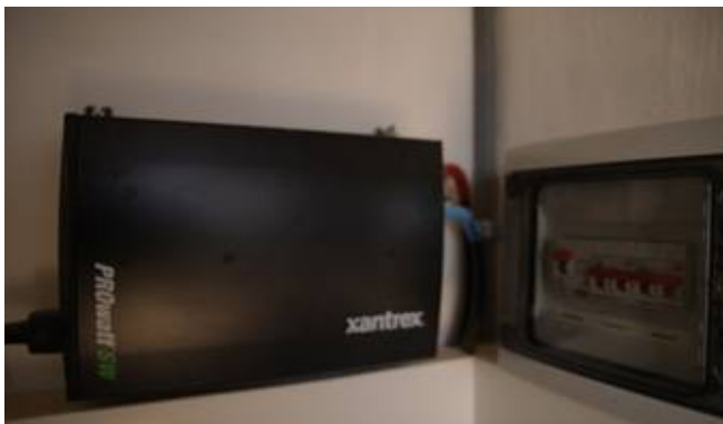
Instalación eléctrica de la quesería de Aguilar de Alfambra
