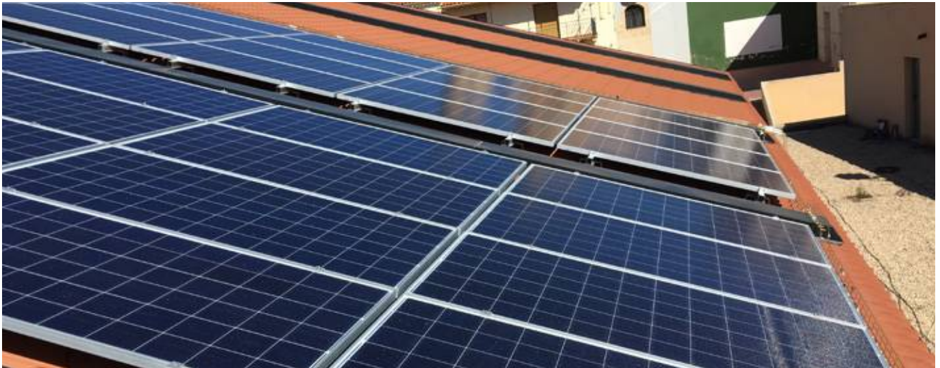
Autoconsumo fotovoltaico en el centro social de Valjunquera
