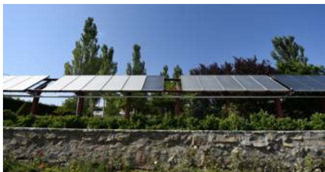
Solar térmica del Hotel Montaña en Rubielos de Mora
