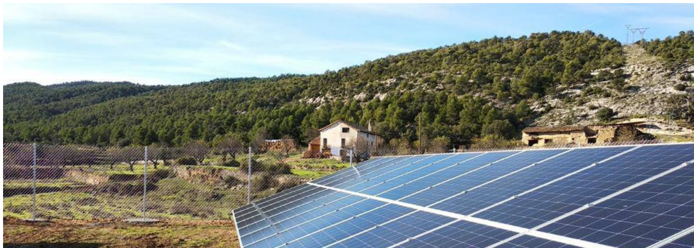
Bombeo solar en Fuentespalda
