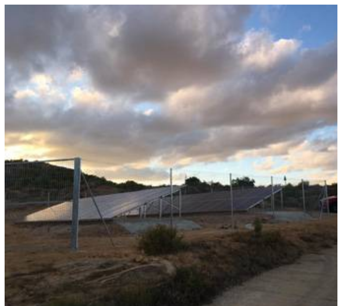
Bombeo solar Alloza
